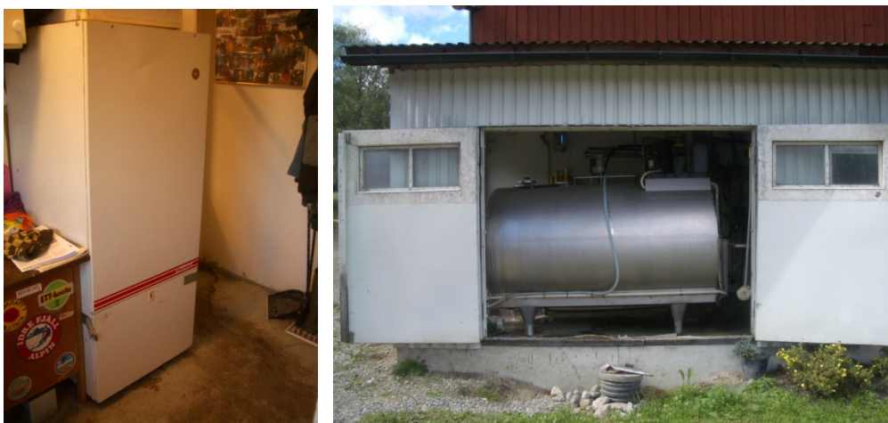
Figur 3-11: Varmvattenberedare för värmning av disk- och rengöringsvatten (t.v.). Mjölktanken sett utifrån (t.h.)
