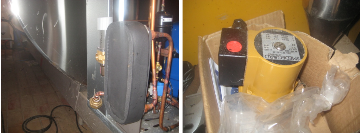
Figur 3-3: Hetgasvärmväxlare för värmeåtervinning men som ej var i drift.
