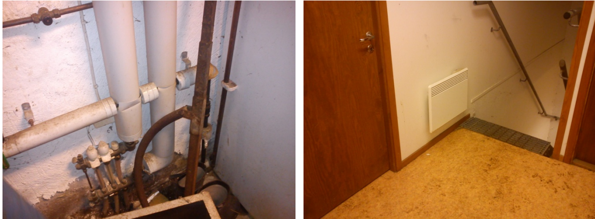
Figur 3-14: Rörinstallation för golvvärme (t.v.) samt direktverkande el till uppvärmning.
